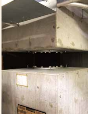
十五番館地下に設置されている免震装置
